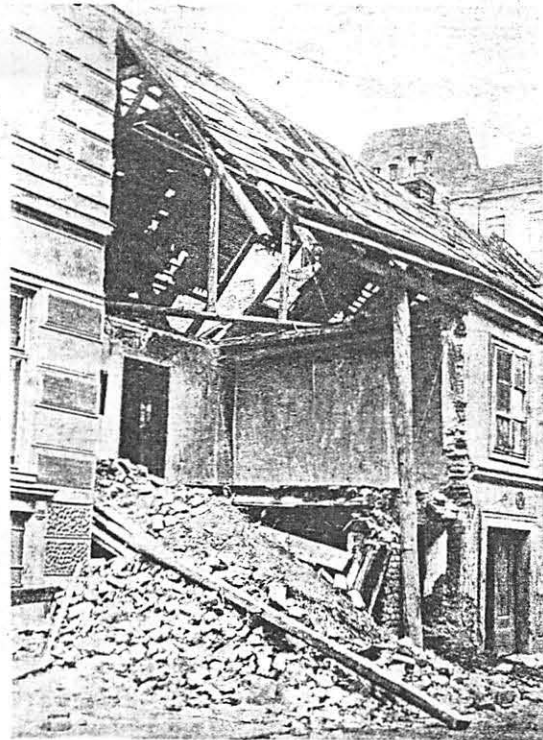
Ein Hauseinsturz in Wien: Das von den letzten Parteien bereits Anfang April geräumte Haus in der Großen Neugasse Nr. 24, das vermutlich im Jahre 1781 gebaut wurde. Phot. S. Uttenbaler, Wien.
